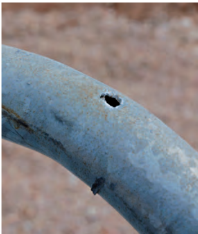
Eine zu dünne Verzinkung führte zu Korrosionsschäden
