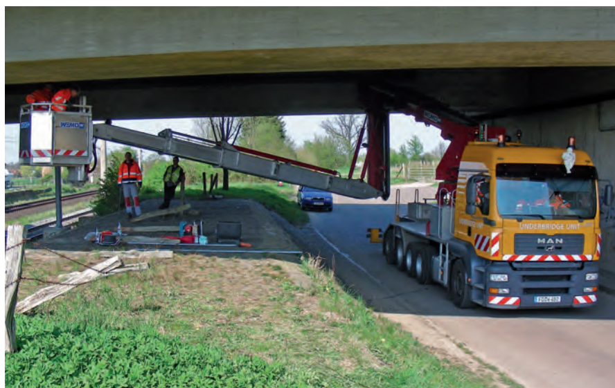
Während des Fahrbetriebes an der Eisenbahnstrecke installieren Mitarbeiter der MPA Braunschweig eine Messstation unter der Autobahnbrücke
