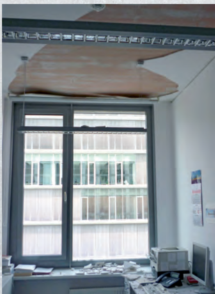
Herabgefallener Gipsputz von einer Stahlbetondecke
