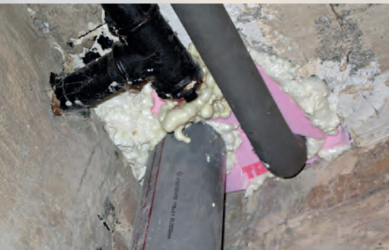
Abb. 3: Rohrleitungen für Versorgung und Entsorgung innerhalb eines Gebäudes, eingebaut neben einer Bestandsleitung in einer Massivdeckenkonstruktion
