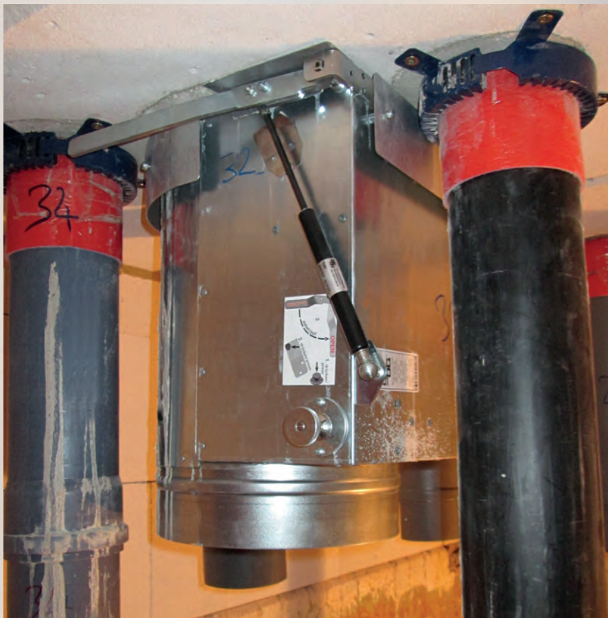
Abb. 1: Einbau der Brandschutzklappen in Verbindung mit den Rohrabschottungen (Auslöseeinrichtung im Brandraum)
