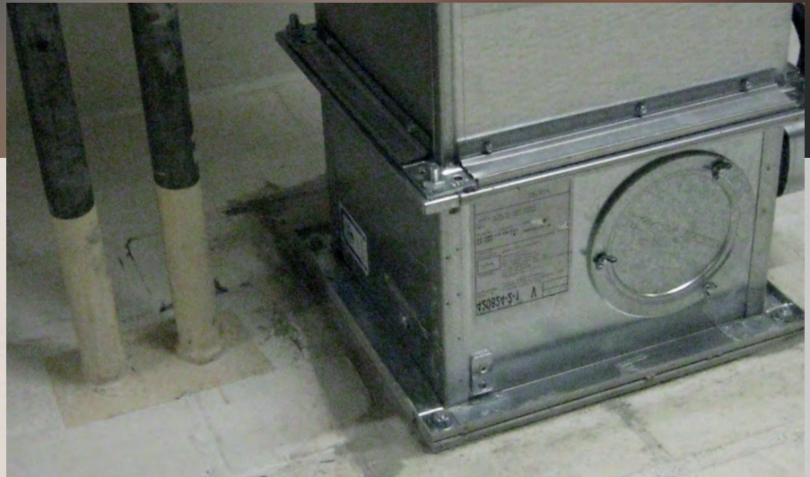
Abb. 2: Brandschutzklappe einer Lüftungsleitung im eingebauten Zustand neben nichtbrennbaren Rohrleitungen
