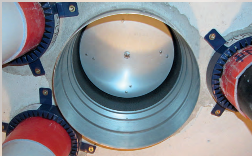
Abb. 6: Einbau der Brandschutzklappe in Verbindung mit den Rohrabschottungen in der Massivdeckenkonstruktion (Auslöseeinrichtung außerhalb des Brandraums)
