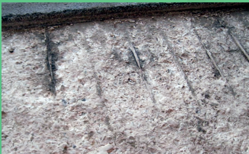
Chloridkorrosion an schlaffer Bewehrung einer Brücke
