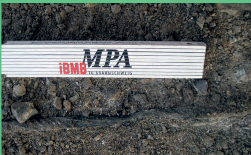
Chloridkorrosion an schlaffer Bewehrung einer Brücke
