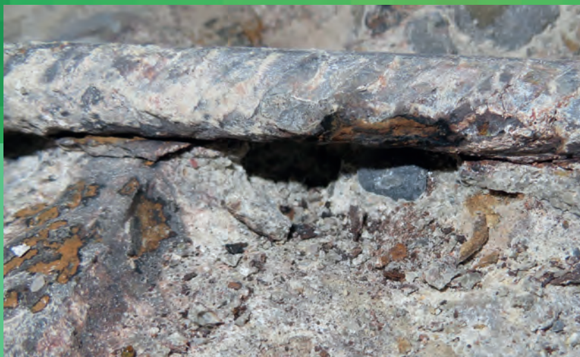
Chloridkorrosion an Bewehrung
