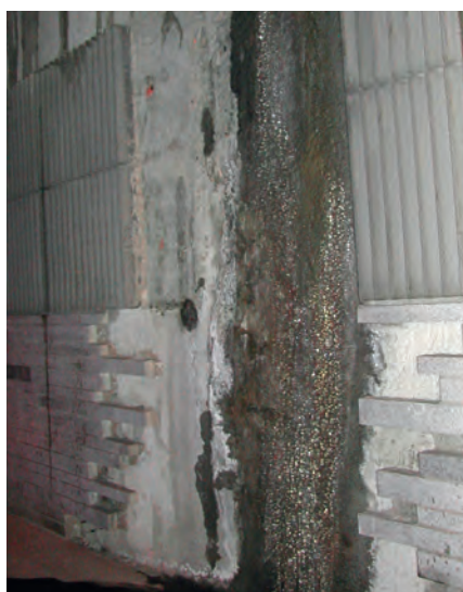
Bild 1: Druckwasserführende Pressfuge in einem Tunnelbauwerk
