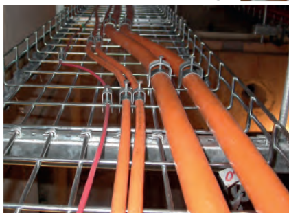
▲ Kabelanlagen im Einbauzustand
