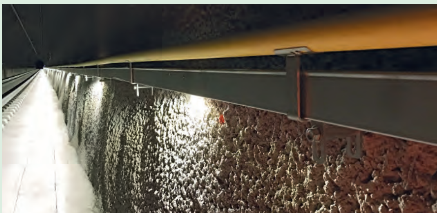
Kabelanlage der Firma Woertz AG im Ölbergtunnel (Schweiz)
