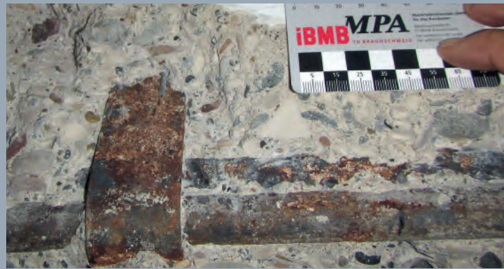
Freigelegte Bewehrung eines Unterzuges (Bj ca. 1915): Längsstäbe aus glattem Bewehrungsstahl I, Bügelbewehrung aus Flacheisen
