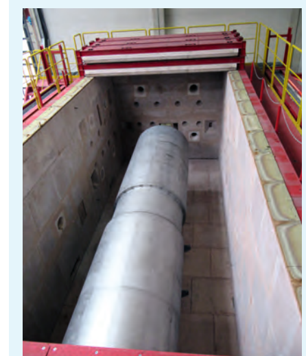
Installation eines 7,5 m langen Strahlventilators mit beidseitig angeordneten Schalldämpfern (Fa. FAWNET S.A.) bei geöffneten Deckenteilen
